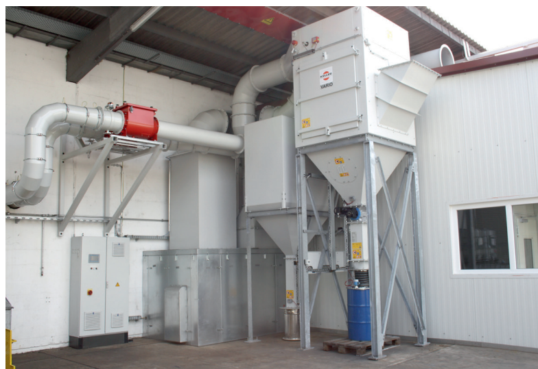
An den Putz- und Kontrollstrecken der Stahl-/Aluminium-Fertigung ist eine neue Trockenabsaugung im Einsatz. Sie ist besonders effizient und leise.
